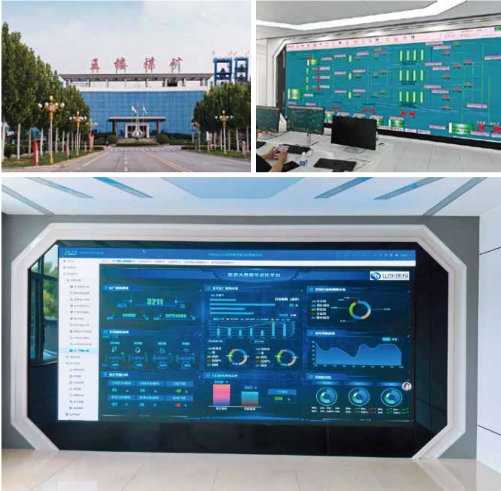
山东能源 王楼煤矿 监控及LED项目 业务类型：矿山安防、可视化显示 项目内容：视频监控系统搭建、LED大屏安装 适用场景：煤矿日常安防、生产数据展示
