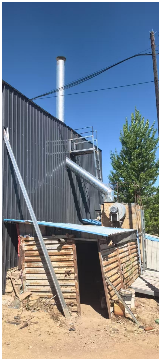
图 3-2 石子石粉生产线除尘器及排气筒照片
