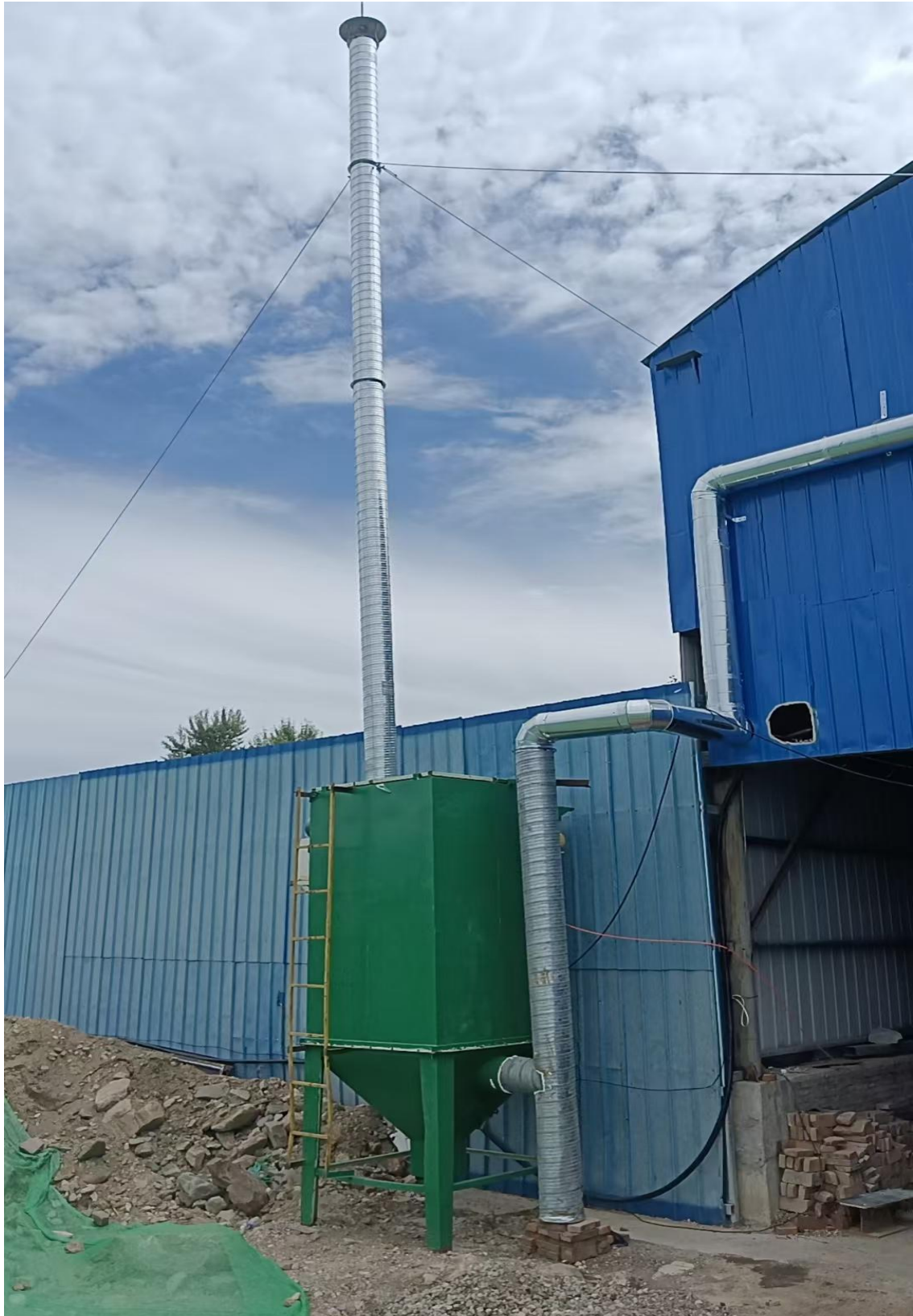
图 4-2 除尘器 、排气筒
