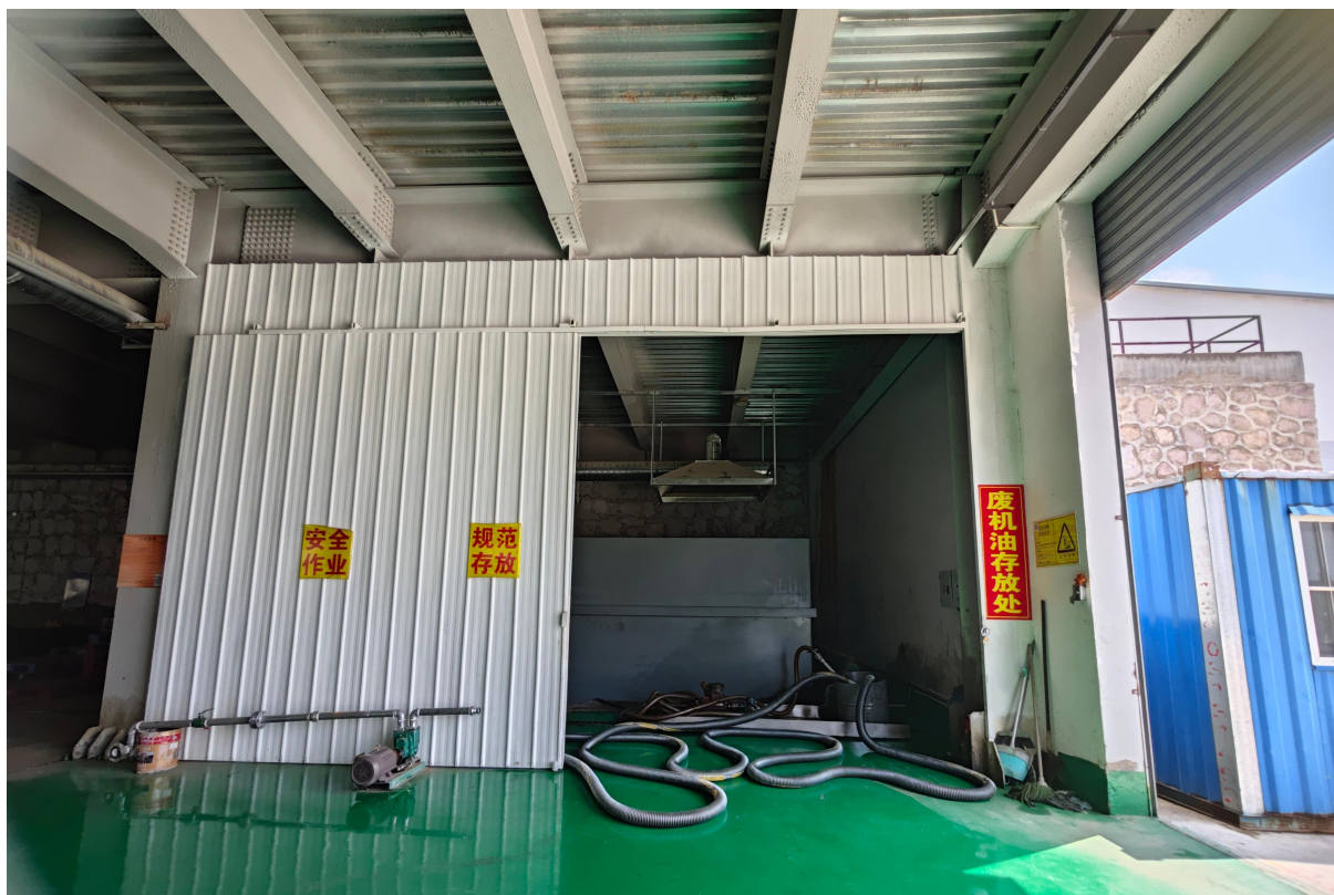
废机油存放处
