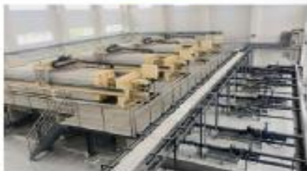
绵阳污泥干化处理
